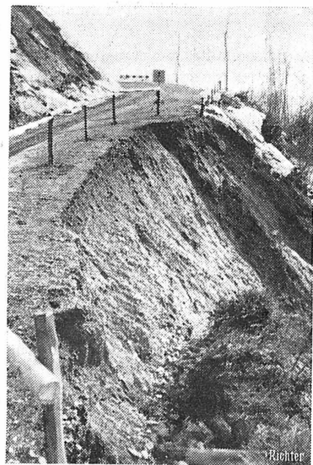
A gauche: une vue de la route de Gryon à Bevilacqua qui s'est effondrée en raison des grandes quantités de neige tombées et de l'humidité qui en est résultée. A droite: Mme Corinne Bille qui vient de recevoir le prix littéraire Bock Esenwein pour son ouvrage «Le grand tourment», prix qui récompensait la meilleure oeuvre littéraire de Suisse romande.
