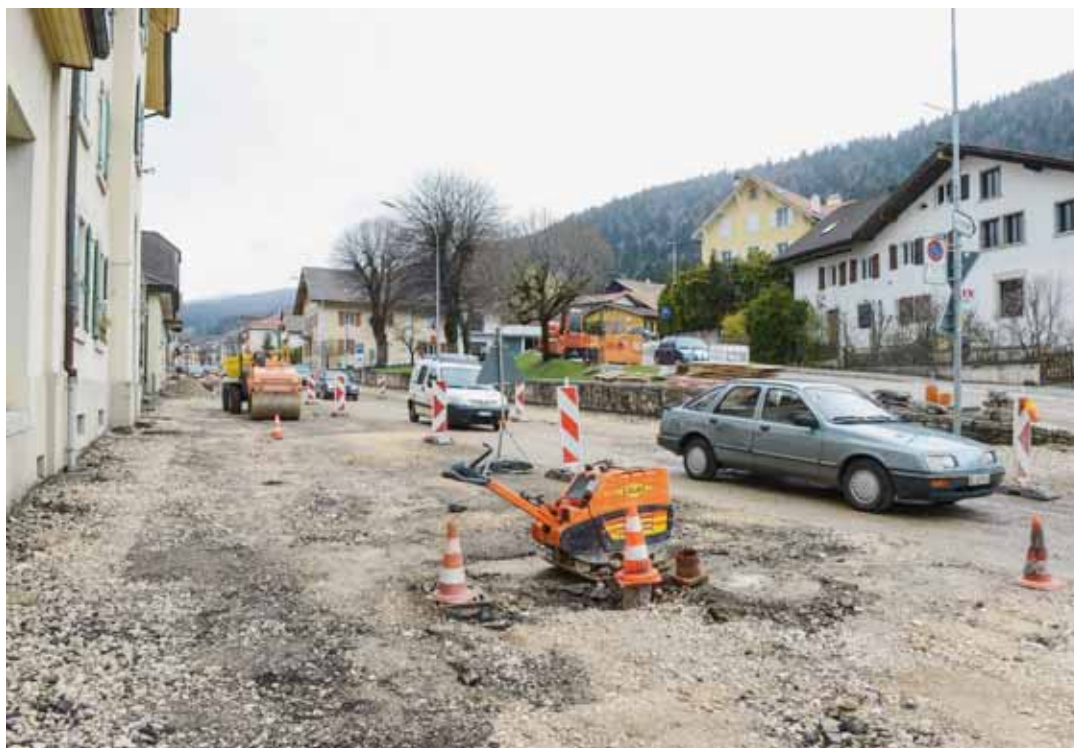
Le tapis routier de la principale artère de Cernier a été raboté à proximité de l'intersection avec le Crêt-Debély. La signalisation lumineuse mise en place provoque d'inévitables perturbations. CHRISTIAN GALLEY
