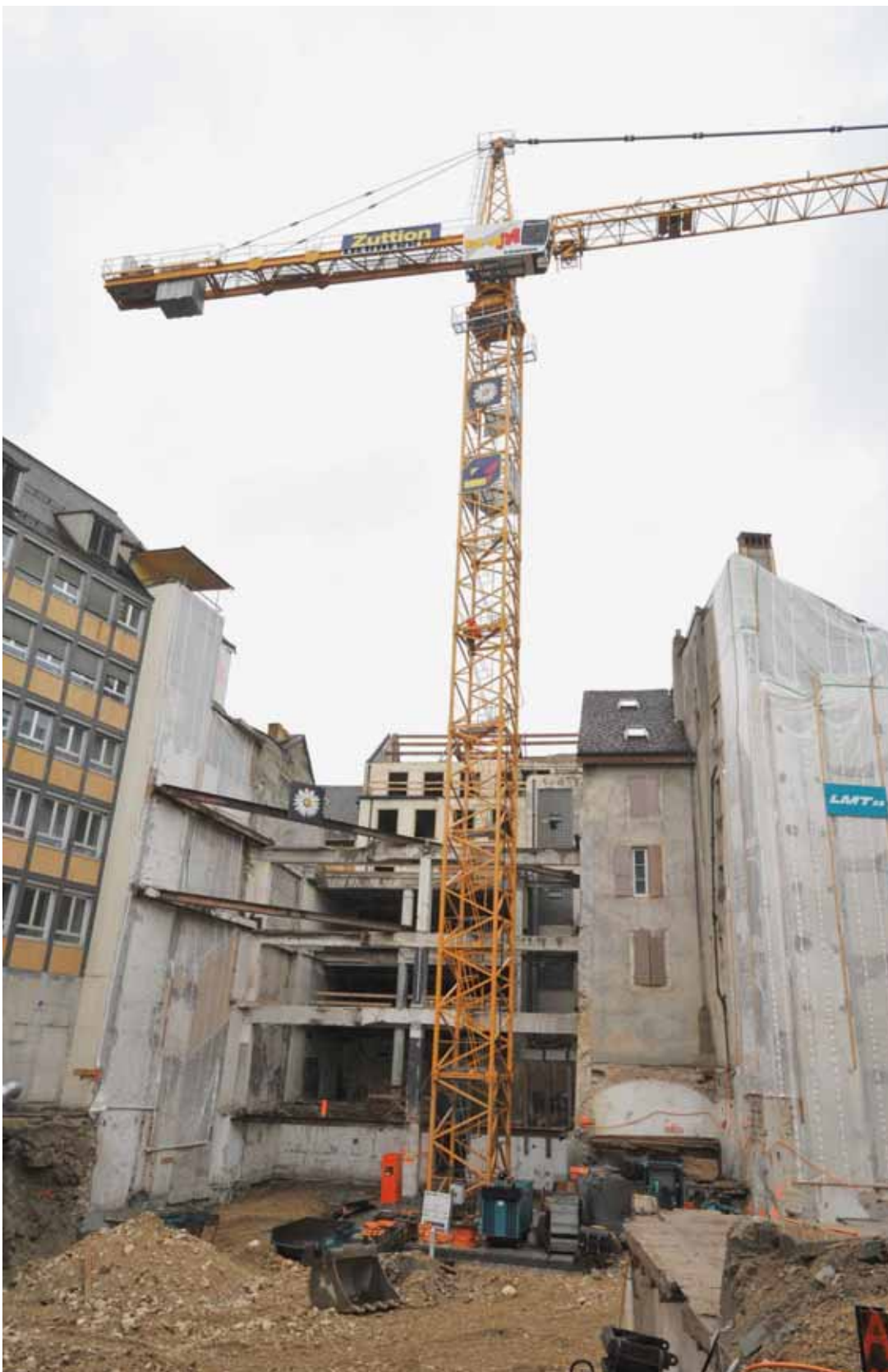
La grue du chantier des Armourins culmine à près de 40 mètres, et son bras mesure 60 mètres de long. Un monstre difficile à encastrer dans l'enceinte des travaux, très réduite. RICHARD LEUENBERGER
