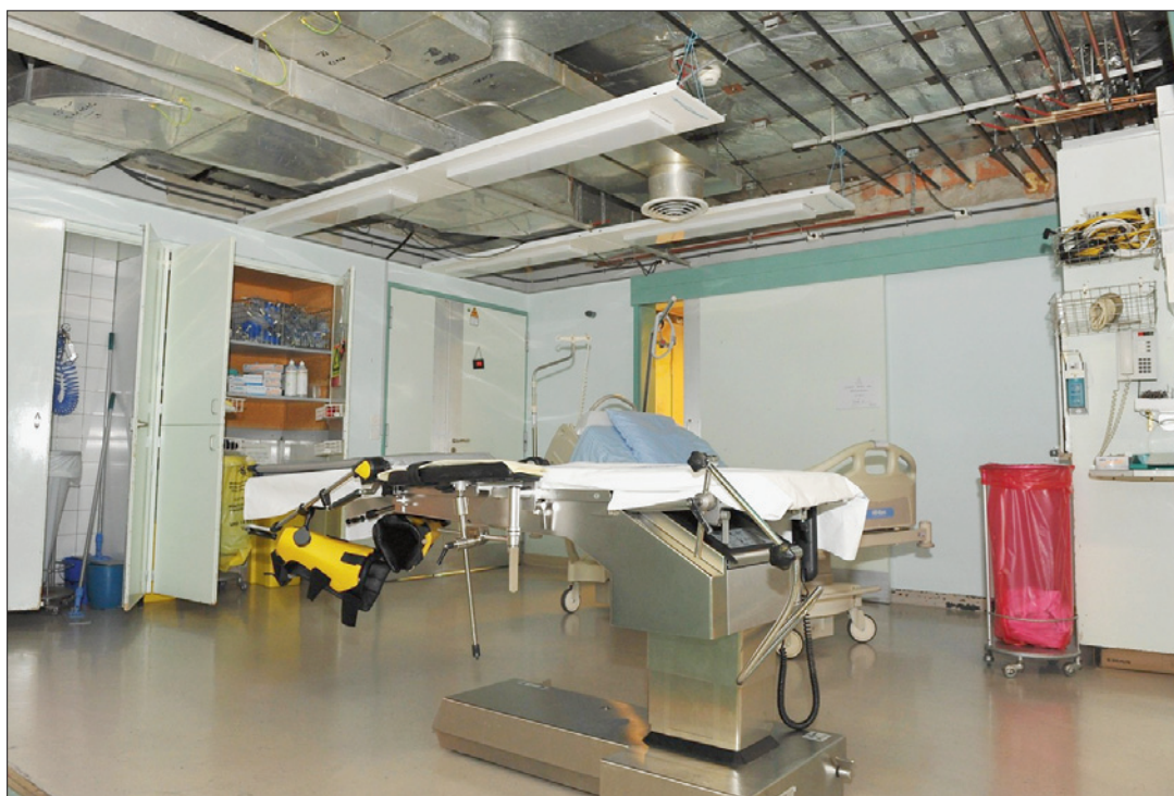
LA CHAUX-DE-FONDS Les salles d'opération actuelles sont dans un état de délabrement avancé. Une d'entre elles a d'ailleurs dû être fermée. Leur remplacement est donc devenu urgent. (ARCHIVES RICHARD LEUENBERGER)
