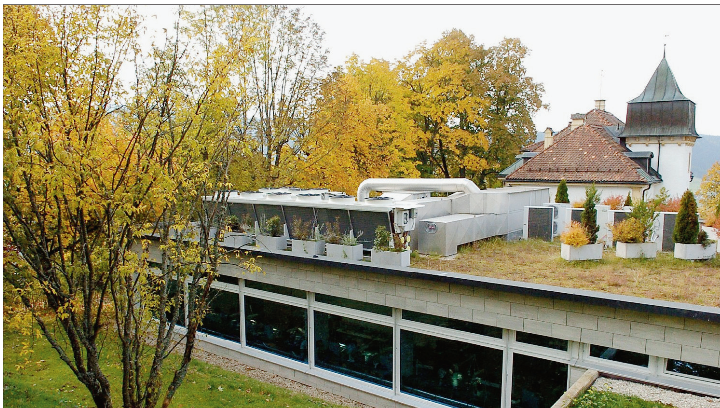
ÉCONOMIE A l'extrême gauche du toit, les serpents de diffusion contenant l'eau destinée à rafraîchir le bâtiment. A droite, on voit encore les anciens climatiseurs, qui seront évacués sous peu. (RICHARD LEUENBERGER)
