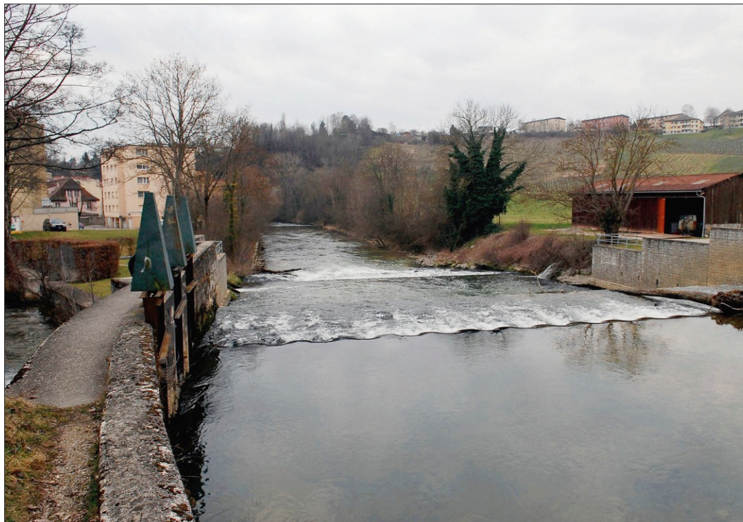
BOUDRY Le promoteur de la minicentrale prévue à Pontareuse se plaint des lenteurs de l'Etat, qui explique son retard par une volonté d'avoir une vue globale des installations projetées dans le canton.
