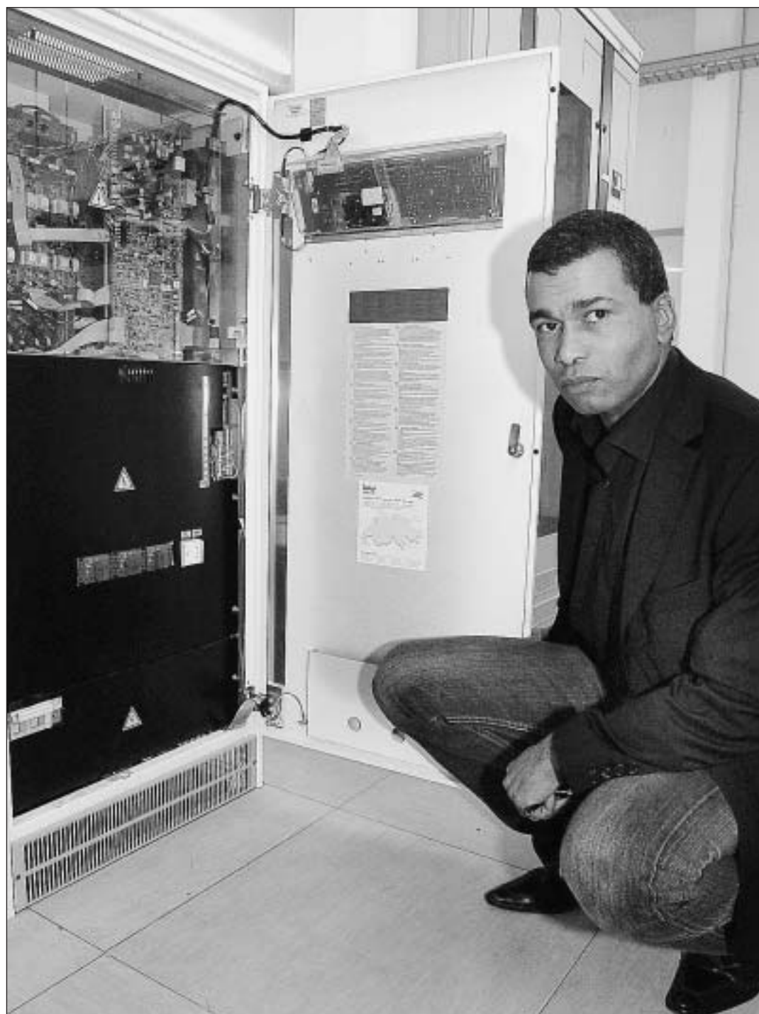
Stéphane Reichen, responsable technique de l'hôpital Pourtalès montre l'intérieur de l'onduleur défaillant.
