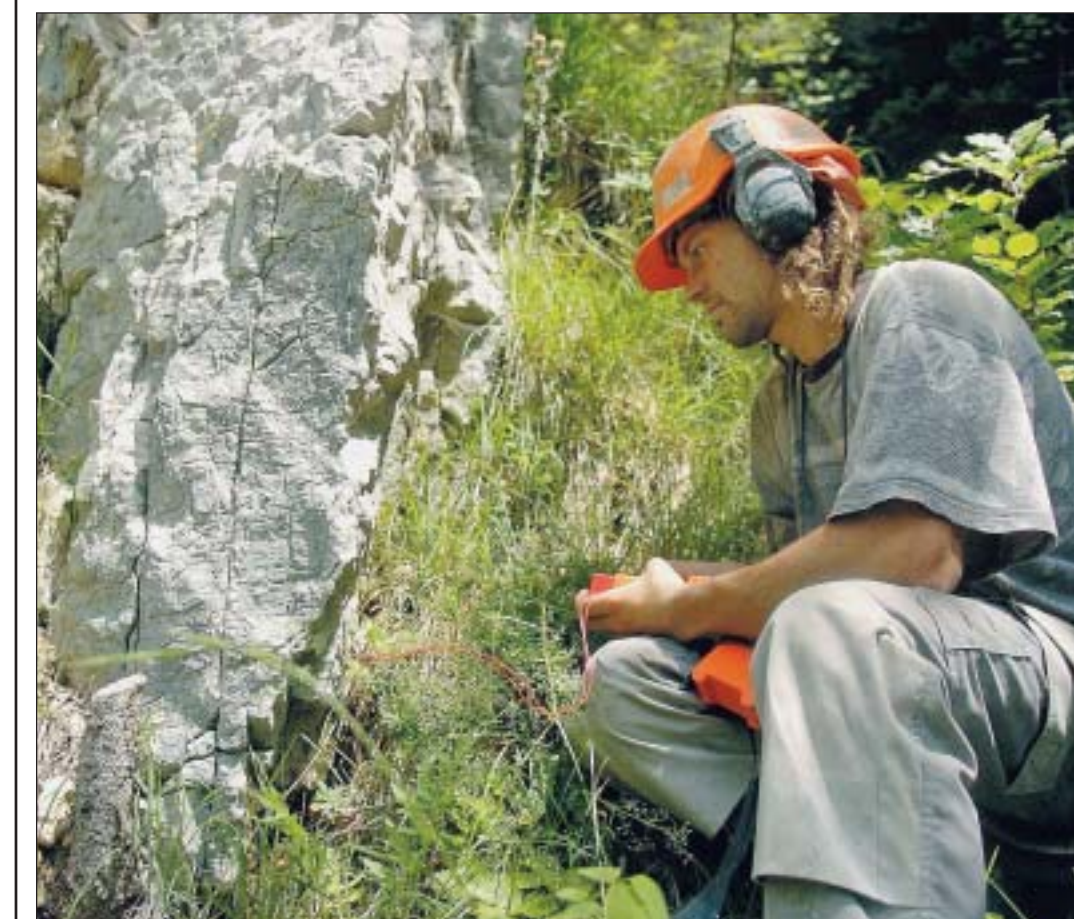
Julien Schoch, de l'entreprise spécialisée Acro Bât, a glissé en sept points deux kilos d'explosifs dans le rocher. Abris plus loin, il est prêt à le faire sauter.
