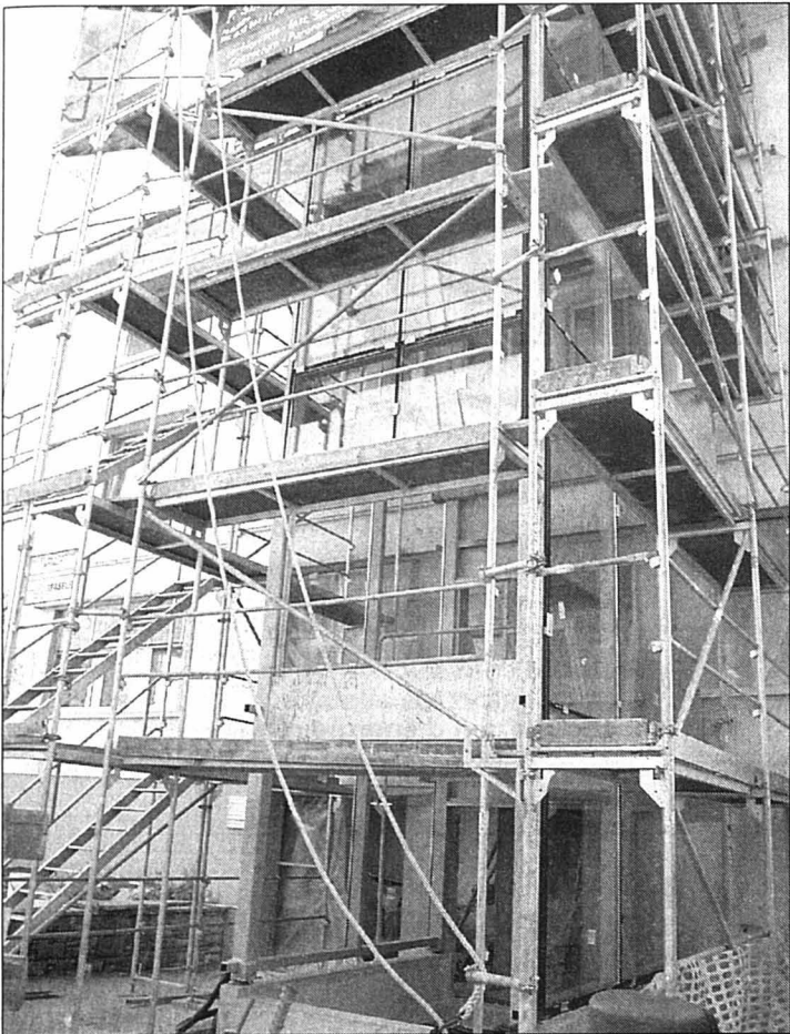
Les travaux d'installation de l'ascenseur extérieur au home Valfleuri, à Fleurier, sont déjà bien avancés.
