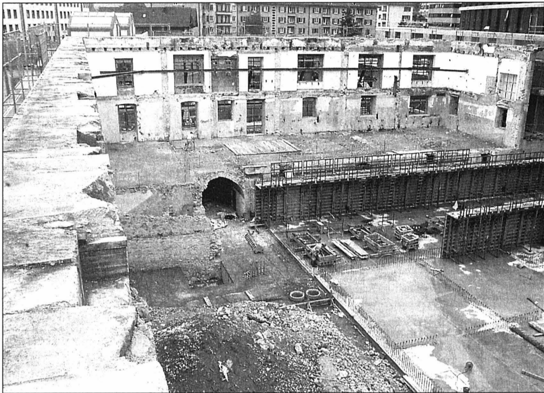
Enfin, seules les façades du bâtiment de 1811 (ici, la «cour» intérieure) ont pu être conservées.
