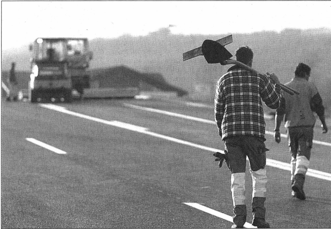
La réduction des crédits routiers fédéraux risque de décaler les travaux restants sur l'A5 d'un an (ici à Areuse). Et de renvoyer l'inauguration au printemps 2006. PHOTO MARCHON
