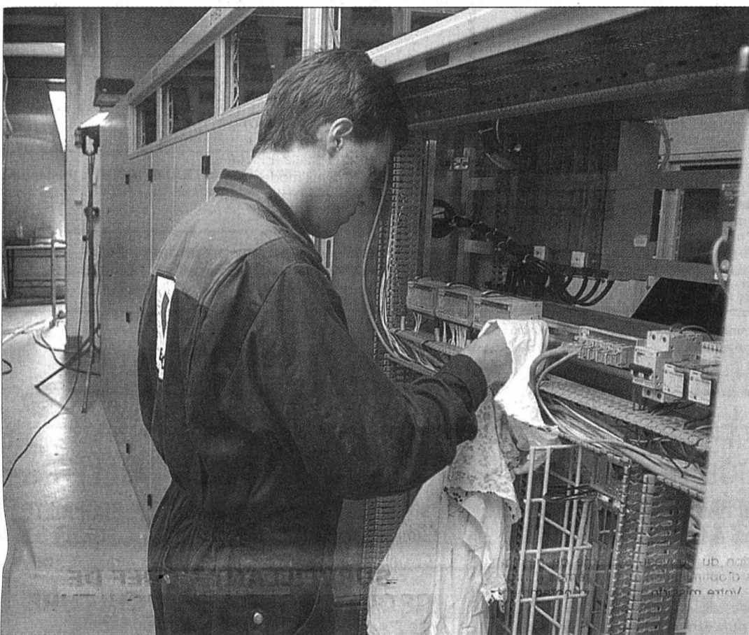
Nécessaires à la sécurité des usagers du tunnel autoroutier, les installations touchées doivent être traitées une à une.
