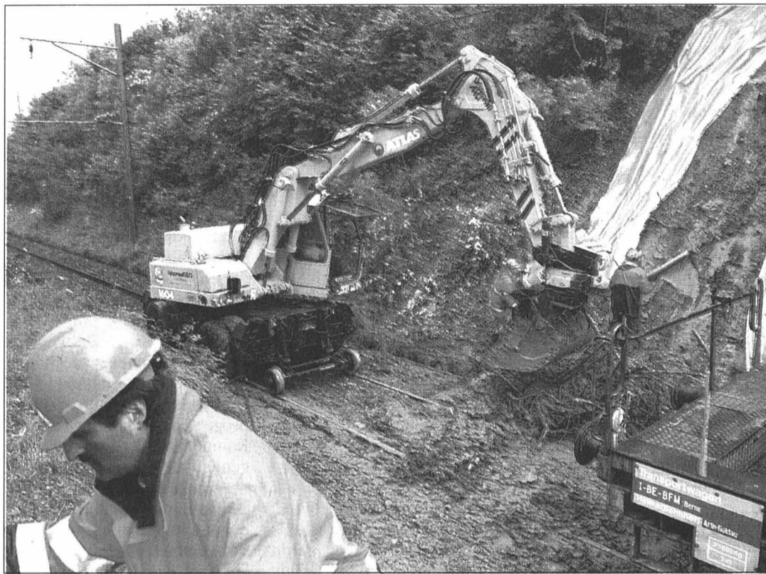
Dans le canton d'Obwald, de nombreuses lignes ferroviaires ont été coupées.
