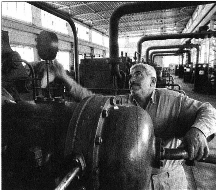
Un technicien irakien nettoie une installation déjà ancienne avant son redémarrage, hier dans la station de pompage de Kirkuk. PHOTO KEYSTONE
