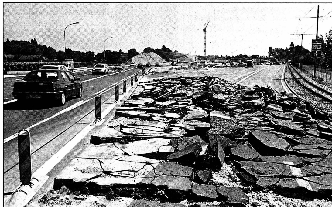
Après l'ouverture de la déviation (vue en direction de Neuchâtel), l'ancienne route bétonnée a été démolie. La voie du Littorail sera également déviée à terme. PHOTO MARCHON
