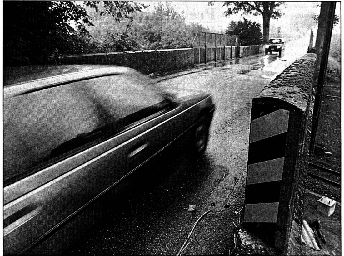
Le pont de Montmollin sera dépouillé de ses deux parapets en pierre, devenus dangereux, et de sa chaussée actuelle. PHOTO MARCHON
