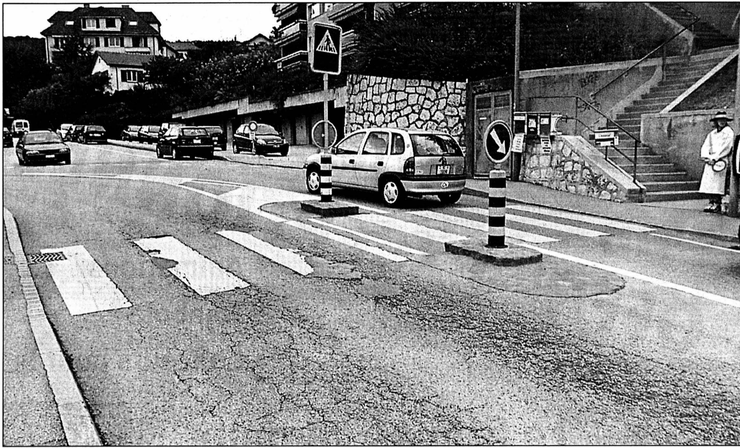
La rue Caselle, en contrebas du quartier des Charmettes, se trouve dans «un état d'usure avancée». PHOTO LEUENBERGER
