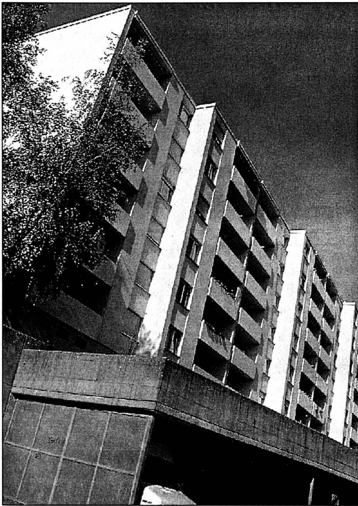
Le Conseil général a dit oui aux patrouilleurs, mais non à la rénovation de la couverture des immeubles Flamme 22, 24 et 26. PHOTO MAIRY
