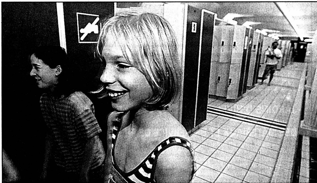
La dalle infiltrée par l'eau supporte les vestiaires intérieurs, largement utilisés en hiver. photo Marchon
