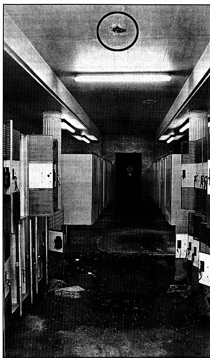
L'eau s'écoule dans les vestiaires extérieurs par des carottages (cercle) pratiqués dans la dalle. photo Marchon
