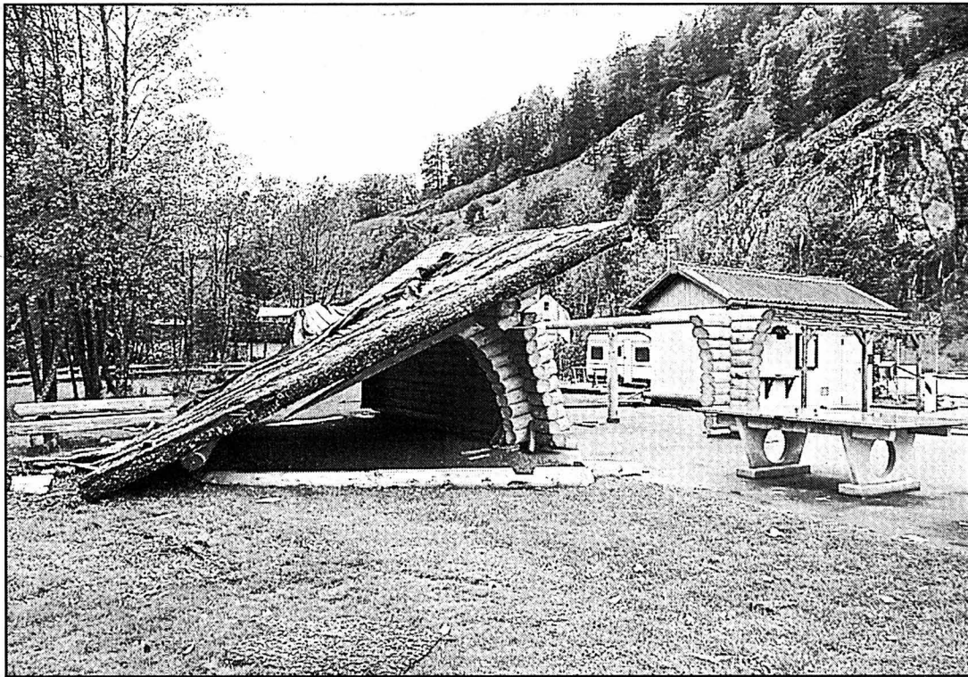
Pesant plusieurs tonnes, le toit avait pourtant été fixé «dans les règles de l'art».
