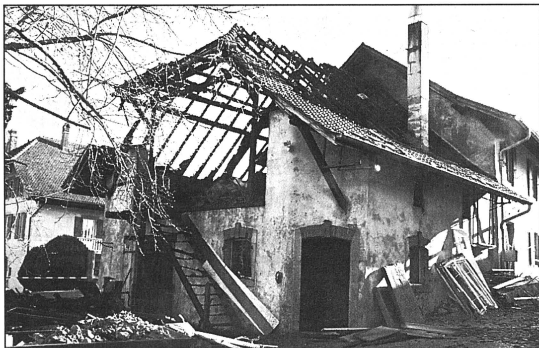
Il a fallu une heure aux pompiers de Marin, appuyés par le SIS de Neuchâtel, pour venir à bout de l'incendie qui a entièrement détruit une maison du Closel-Bourbon à Thielle. photo Marchon
