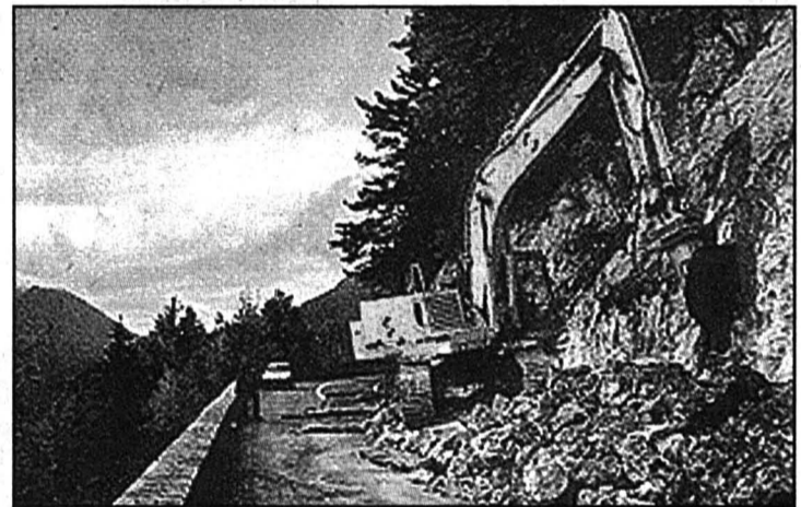
Les trax profitent de la fermeture de la route pour terrasser la falaise située dans le secteur du Long-Mur. photo Bardet
