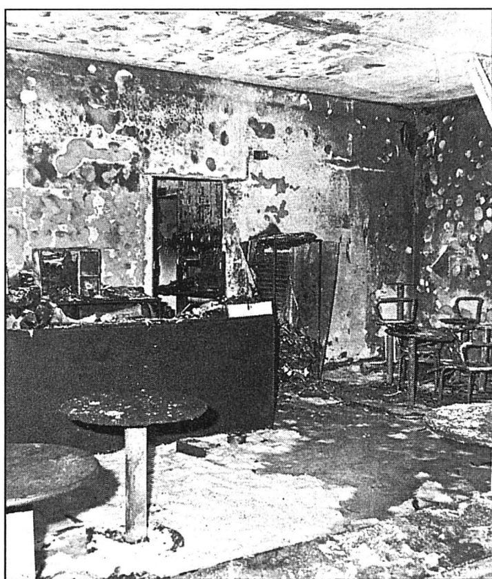
Ce qui restait du snack après l'incendie. photo a-Bardet
