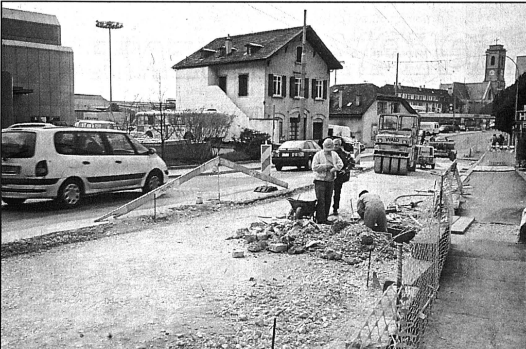
Selon Antoine Benacloche, la simultanéité des interventions des Travaux publics et des Services industriels ne devrait pas trop allonger le chantier. photo Galley
