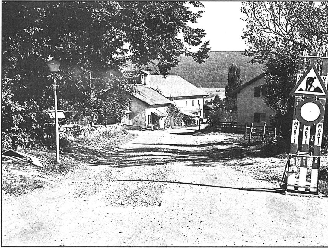
Un programme de travaux chargé pour le hameau de La Jonchère. photo Leuenberger
