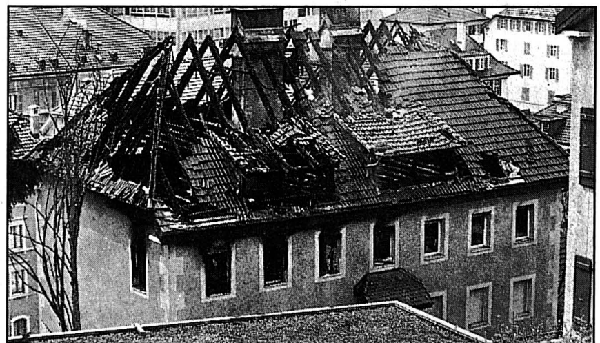
MAISON DÉTRUITE - Les causes du sinistre n'ont pas encore pu être établies. ptr-E
