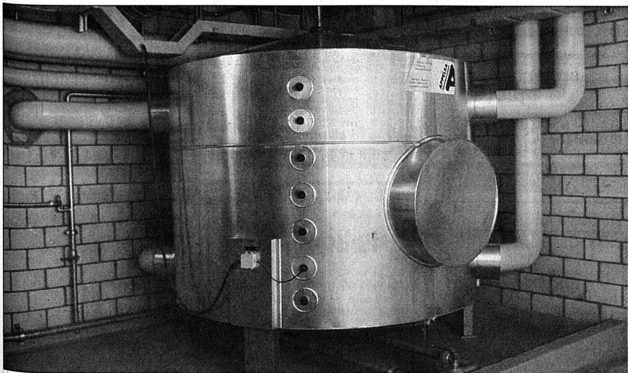
CITERNE — C'est le réservoir d'eau glacée, alimenté par des pompes primaires. Les pompes secondaires, elles, transportent l'eau froide du réservoir aux différentes installations de traitement.
