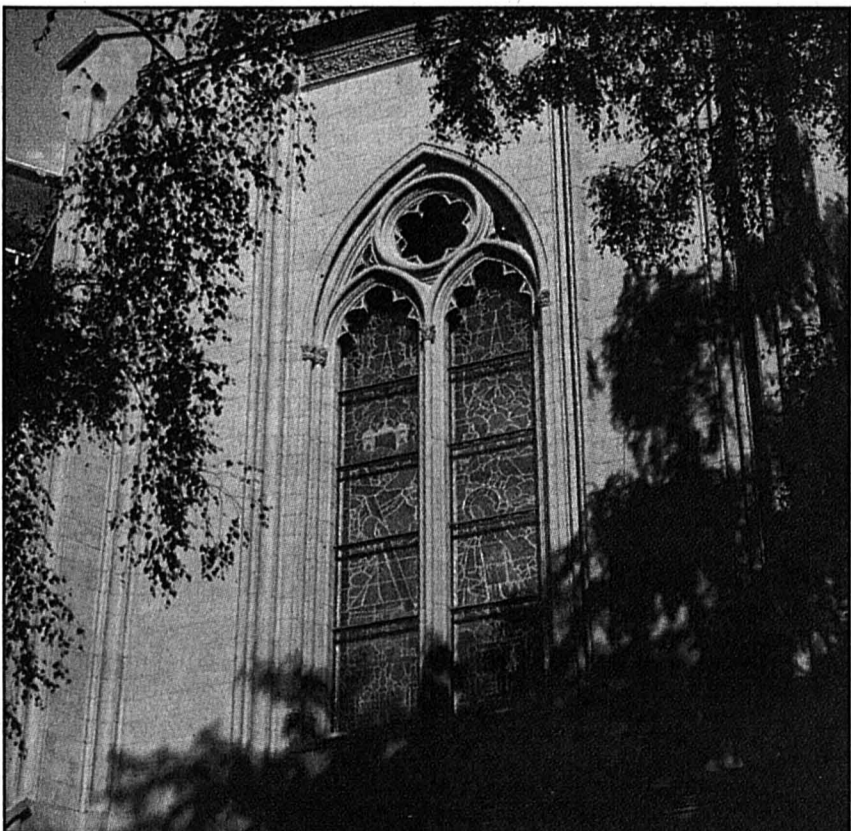
JEUNESSE RETROUVÉE - A la fin de ce mois, l'échafaudage qui ceinture la tour de l'église catholique Notre-Dame, à Neuchâtel, devrait avoir disparu. L'ensemble de la rénovation extérieure de l'édifice aura alors pris fin. Ces travaux auront duré deux ans, et la paroisse Notre-Dame y aura investi 2,6 millions de francs.
