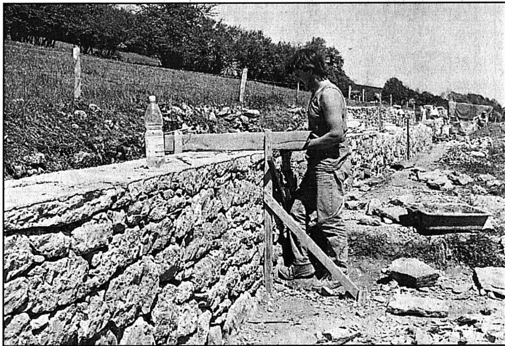
RÉFECTION - La compétence des ouvriers est elle aussi nécessaire à la réussite des travaux.
