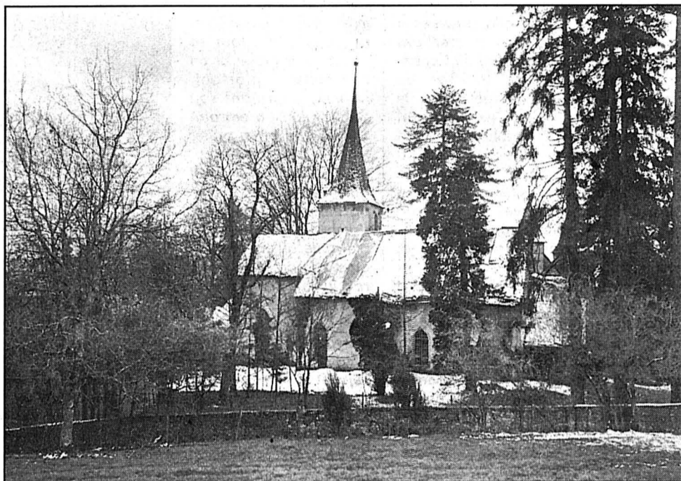
MONUMENT DÉLABRÉ - La toiture de l'édifice requiert des soins urgents.
