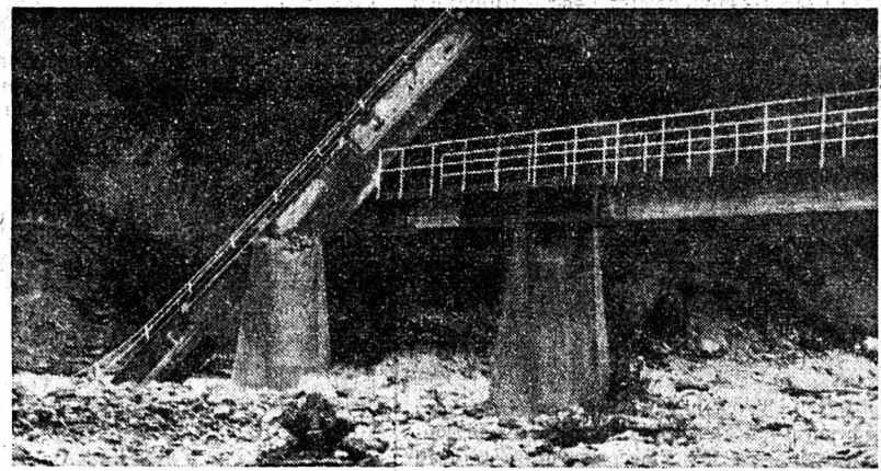
Un pont s'est effondré dans le Val Vigezzo.
