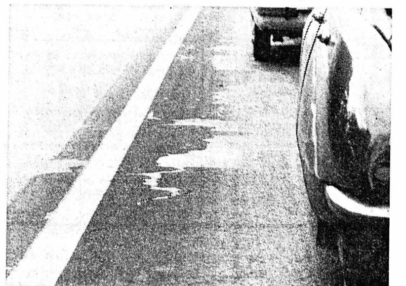
On le constate très bien sur cette photo : le revêtement s'en va en plaques. (Avipress - J.-P. Baillod)
