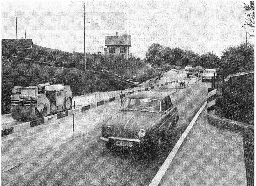
Une vue des travaux entrepris au virage des Platanes à Chez-le-Bart. On a, en fait, coupé le terrain bordant le nord de la RC 5 pour assurer une meilleure visibilité aux automobilistes.
