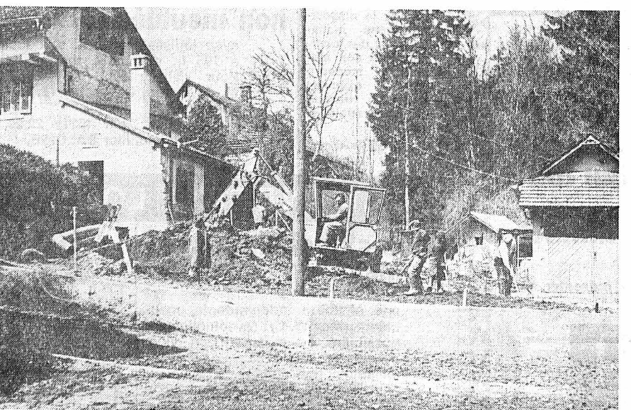
Derrière le quartier des Scies, le long de la Sorge, les travaux avancent assez lentement. Un gros canal-égout vient d'être posé à travers les jardins mêmes. (Avipress - Monnier)
