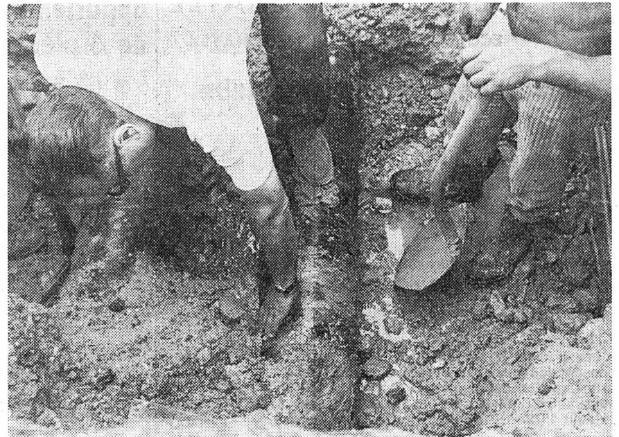
Un employé du service des eaux « ausculte » la conduite qui a éclaté à la suite d'un coup de pioche. Elle était fendue sur une longueur d'un mètre!
