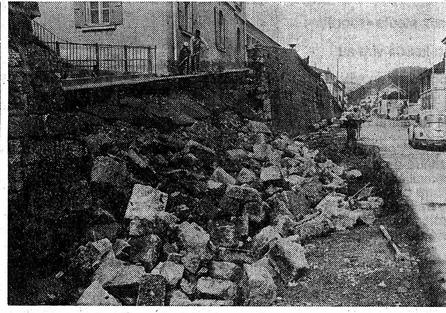
Ce qui reste de ce vieux mur... (Avispress - Schelling)
