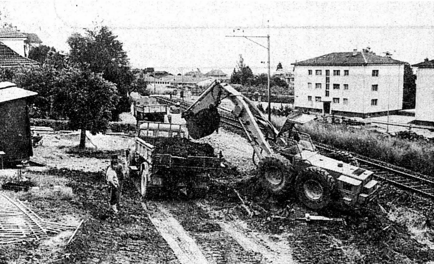
Prélude à l'aménagement d'un passage sous la voie des CFF, au terminus des trams, près du passage à niveau qui vit ses derniers mois.
