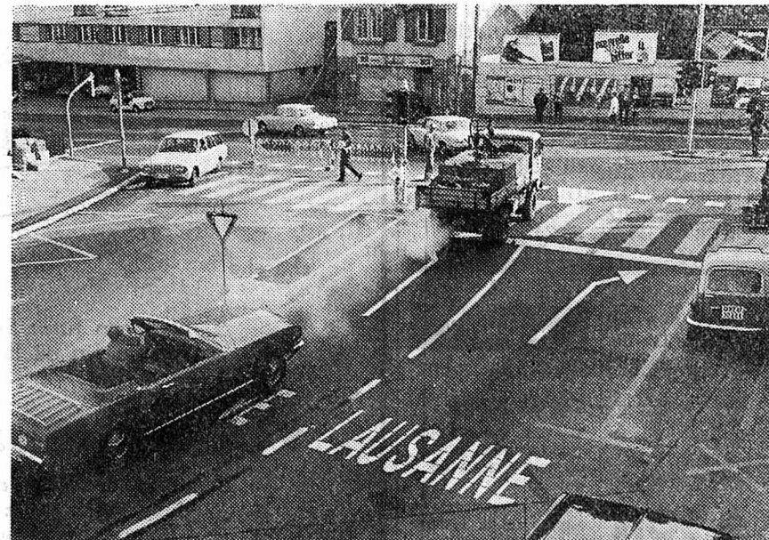
ACCIDENTS. — Ils pourront être évités au maximum grâce aux installations qui viennent d'être achevées.
