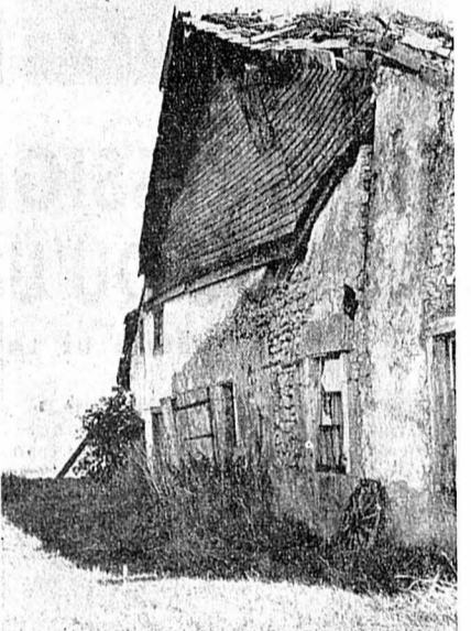
Une partie de la façade nord s'affaissa.
