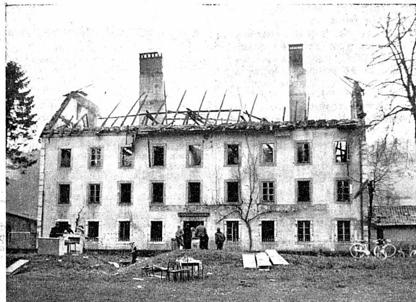
De l'ancien pensionnat des Verrières, il ne reste que les murs calcinés et deux cheminées. Les six appartements ont été détruits par l'incendie de la nuit de samedi à dimanche.
