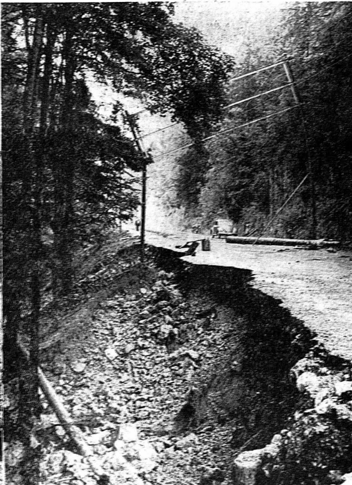
Sur la route de la Tourne, peu au-dessus du virage d'où part le chemin de la Sagneule, le torrent a arraché la banquette et renversé un portique de la ligne électrique de la Chaux-de-Fonds.
