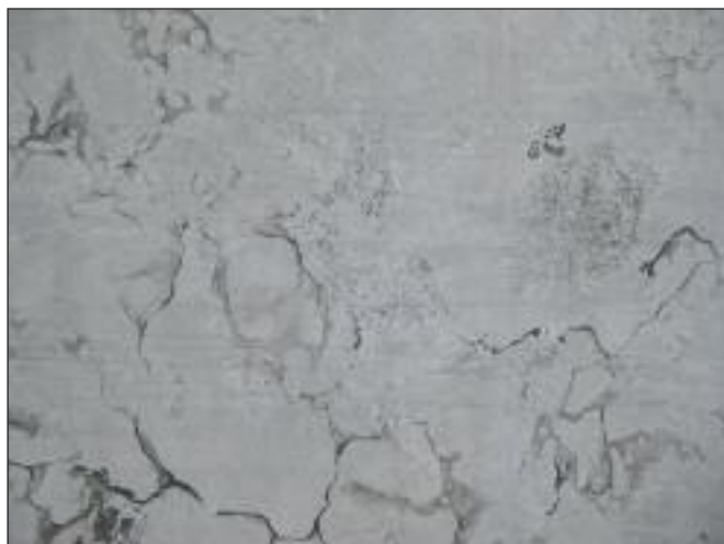
Fig. 14 - Calcaire de Saint-Triphon, parement d'immeuble ayant subi l'altération météorologique.
