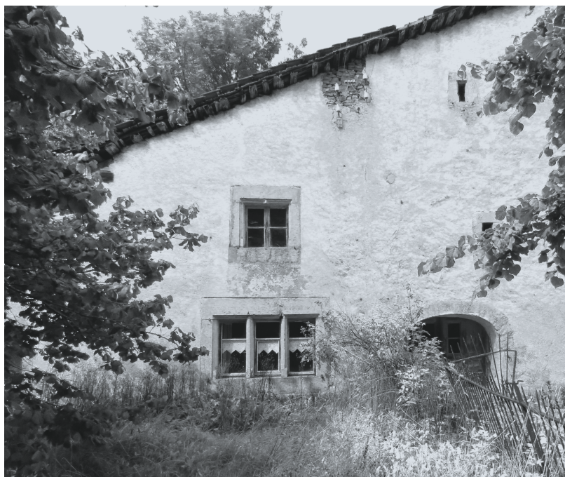
La ferme de La Bosse avant le début des travaux, en août 2019.
