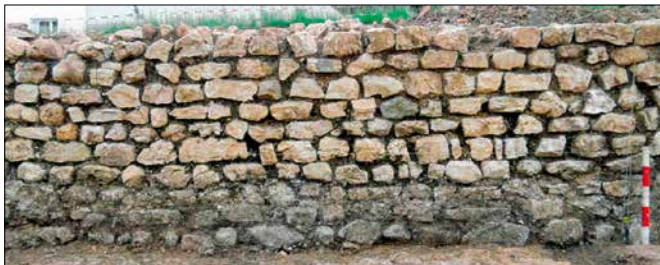
Abb. 142. Die römische Hangstützmauer (M6) in Erschwil (SO) erinnert aufgrund ihrer unregelmässig geschichteten Mauersteinen an die vergleichbaren Mauern des Halbkellers.
