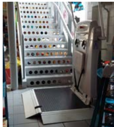
Une plateforme a été installée pour permettre l'accès au premier étage de la Ludothèque aux personnes à mobilité réduite.
