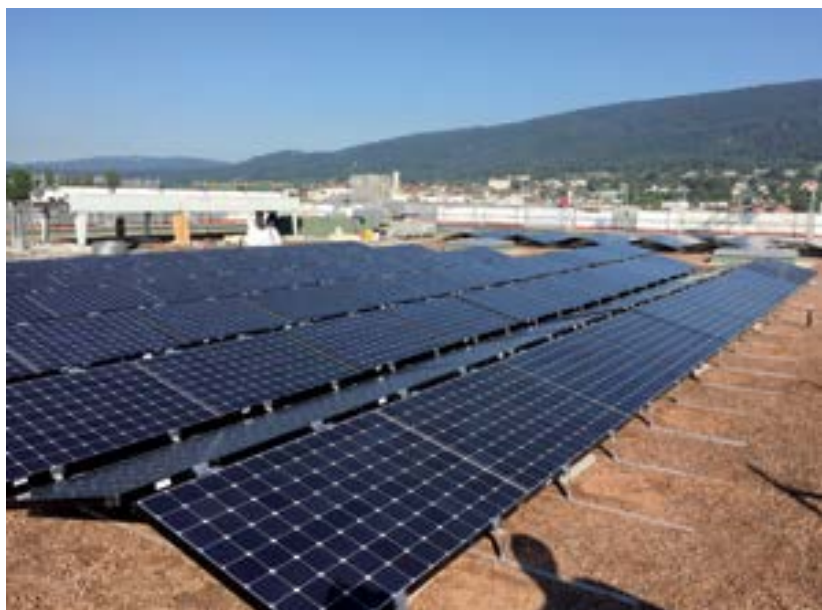
Environ 50'000 kWh seront produits chaque année par les 270 m 2 de panneaux solaires installés sur le toit de Cinemont SA.
