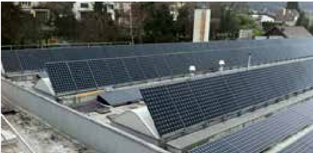
Centrale photovoltaïque sur la toiture nord de Wenger SA.
