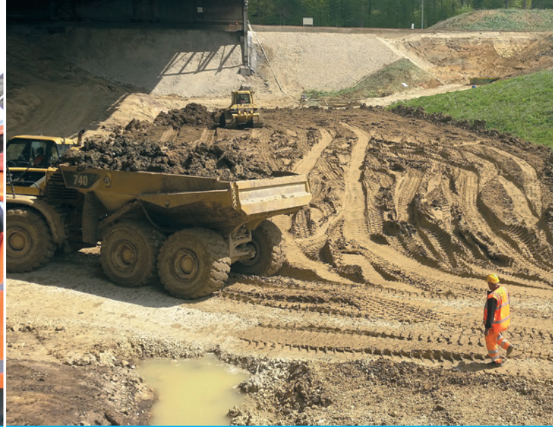
Le remblai de la partie nord commence à l'ancienne façade sud et rejoint la partie remblayée en 2015.
