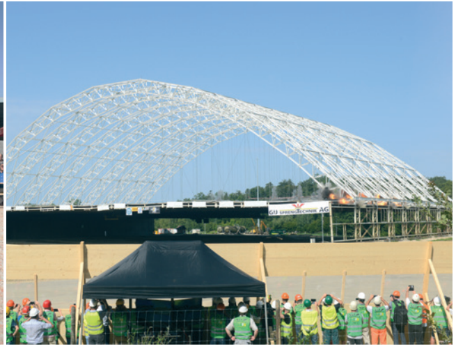
11h07 : allumage simultané des charges sur les tirants. De nombreux invités suivent cet instant derrière la palissade de protection.
