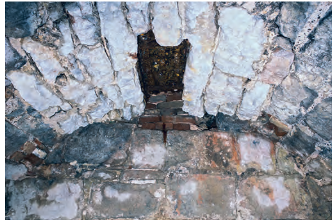
Fig. 67. Vue du carneau Ca1 à son arrivée sous la grille de la tonnelle nord. Le carneau est condamné par une maçonnerie de briques et la grille par une plaque métallique.
