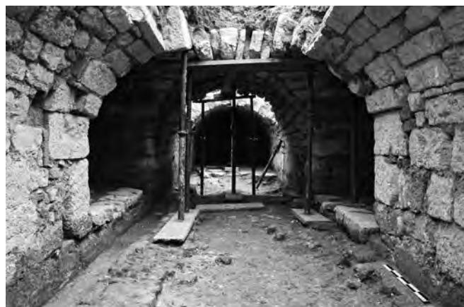
Fig. 38. Vue de l'intérieur de la cave, sous la chambre de fusion, à la croisée de ses bras est-ouest et nord-sud. La canalisation C1 est visible au pied du mur, en bas à gauche.
