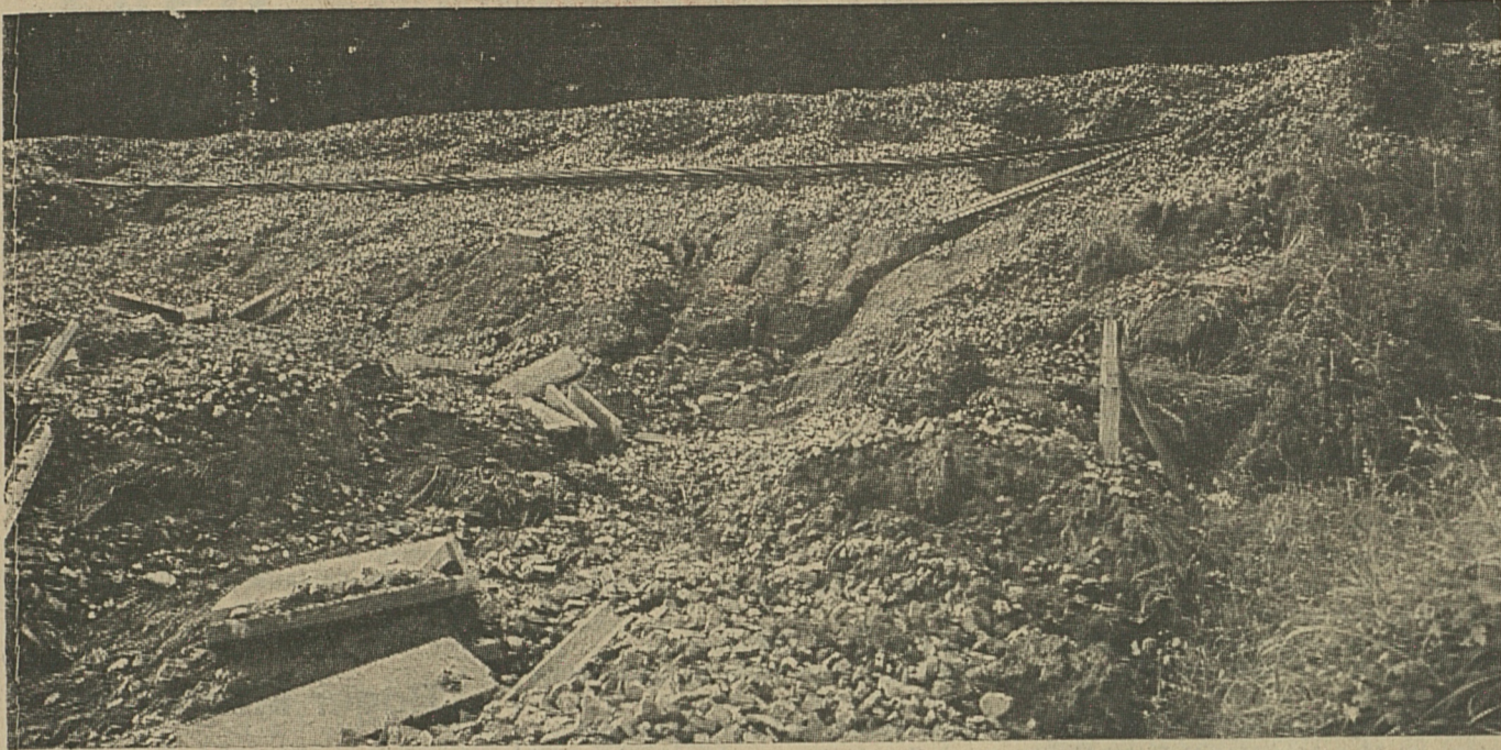
Même ces lourdes briques protégeant les câbles téléphoniques ont été emportées avec le ballast.
